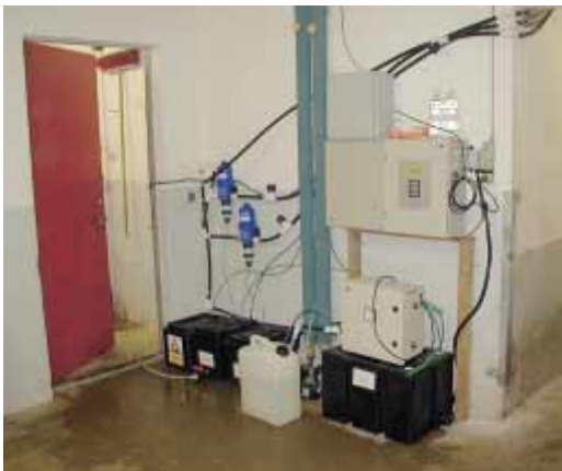
EAW doseringsudstyr monteret på forsøgsstationen.
